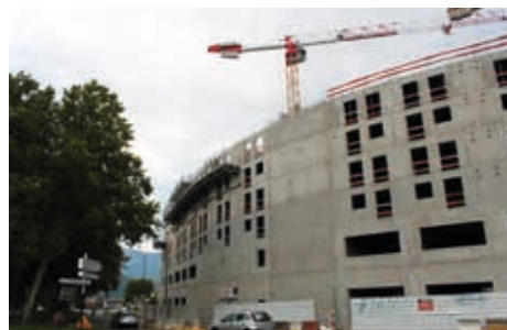
Trois chantiers importants sont en cours : le site du SIERG (notre photo), le projet Navis et l'achèvement du centre-ville avec un centre d'affaires et un complexe hôtelier.
